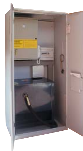
Box locale macchina contenente centralina e quadro elettrico. Cabinet for power unit and control panel.
